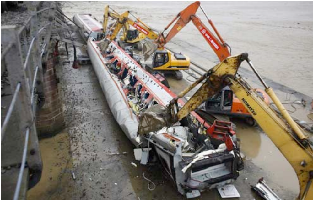
5. számú ábra: Chengdu, Szecsuan fővárosa – árvíz következményeként 2010. aug. 20-án a vasúti híd egy része összeomlott 300
